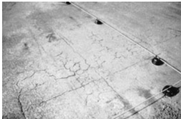
Bild 1: Durch die Witterung beanspruchte und stark gefährdete Dachabdichtung
