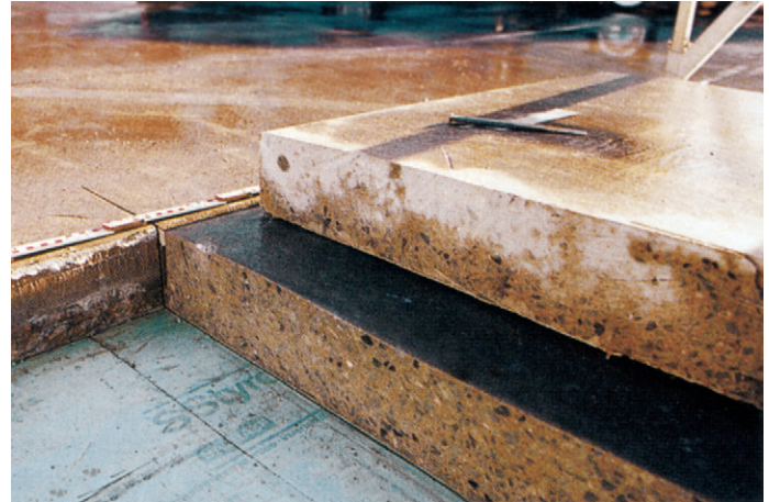
Abb. 3: Aufgeschnittene Ortbetonfahrbelagplatte zur wissenschaftlichen Untersuchung und Bestätigung der langzeitlichen Funktionstauglichkeit der Parkdachkonstruktion
